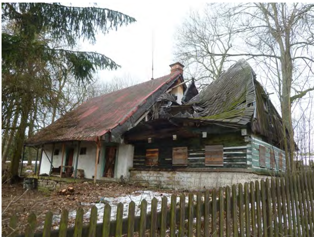
Stav domu č.p. 23 z 1.3.2017 (autor J. Nedomlel)
